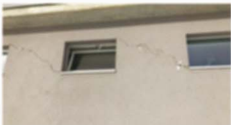
Les fissures sont apparues à différents endroits, vers l'extérieur.
